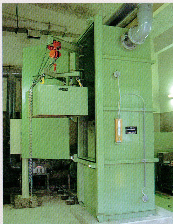
クレーン内装型 活性炭吸着塔
